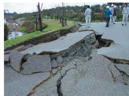
液状化によりガタガタになった歩道 (福岡市内の公園)
